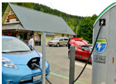
EV Charging Station Áreas de cargar EV (vehículos eléctricos)
