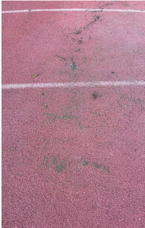
Loose Blades & Fill
